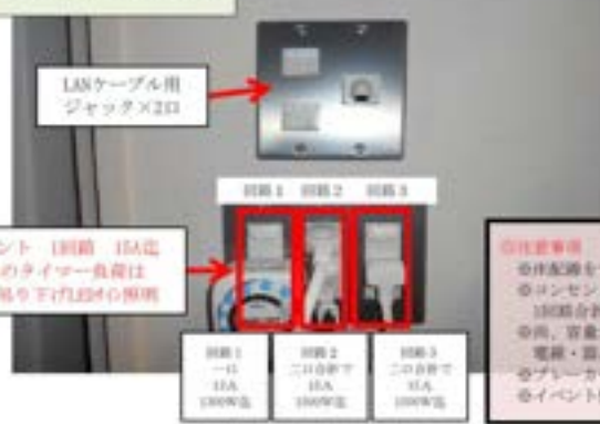
③ノースコート 階段下柱 イベント用増設コンセント
